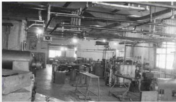
Atelier du département de plomberie-chauffage
